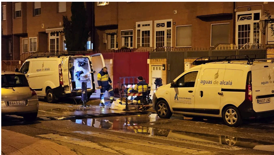
rotura tubería Aviación Española (1)
